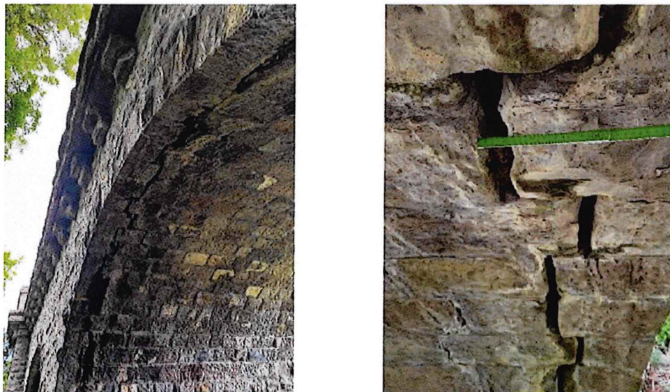
Figure 8 : Fissure de décollement du bandeau
