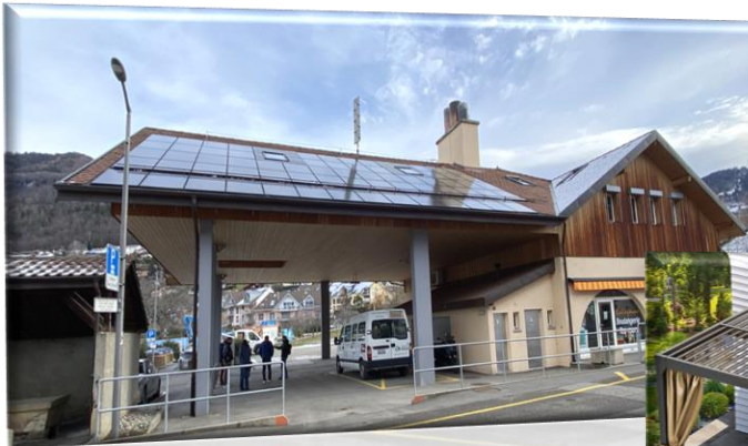
Panneaux solaires sur toiture
